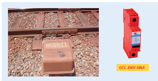
Fig. 10.29 – Fotografia DPS GCL 250V 50kA Classe I, instalado em caixa de junção próxima ao trilho.
