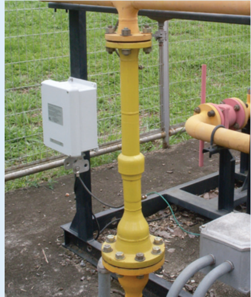
Fig. 10.19 Protetor desacoplador de corrente alternada modelo DDCC instalado no citygate.
