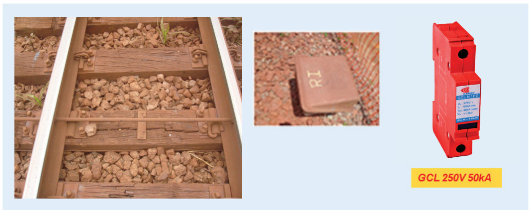
Fig.10.27 - Fotografia DPS GCL 250V 50kA Classe I instalado em caixa de junção próxima ao trilho.
