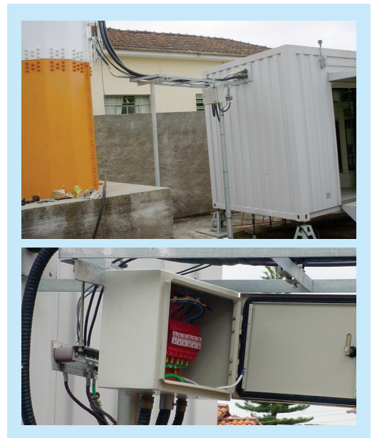
Fig. 9.20 - Detalhe de aplicação de DPS VCL 75V 45kA para proteção de iluminação de balizamento em estação rádio base alimentada em -48Vcc.
