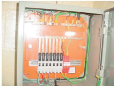
Fig. 8.14 – Fotografias de instalações típicas de DPS em redes elétricas.
