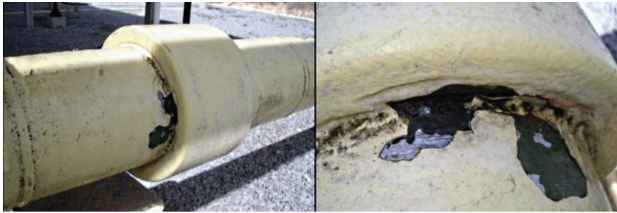
Fig. 10.12 Rompimento de isolamento em junta monobloco devido a descarga atmosférica – Fonte: GASMIG.
