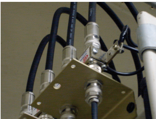
Fig. 9.22 – DPS modelo 812.X.050/N instalado na entrada do prédio ou container.
