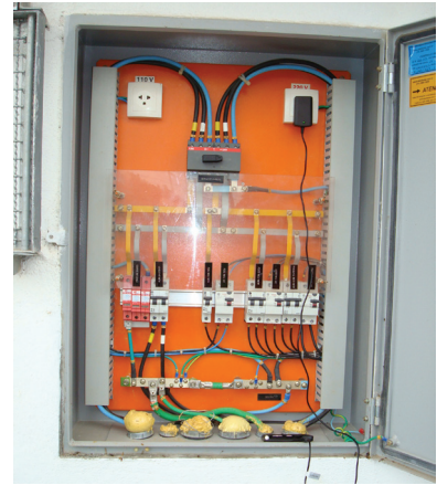
Fig. 9.19 - DPS Classe I modelo VCL 275V 12,5/60kA aplicado na entrada da instalação, próximo ao medidor de energia da concessionária de energia.
